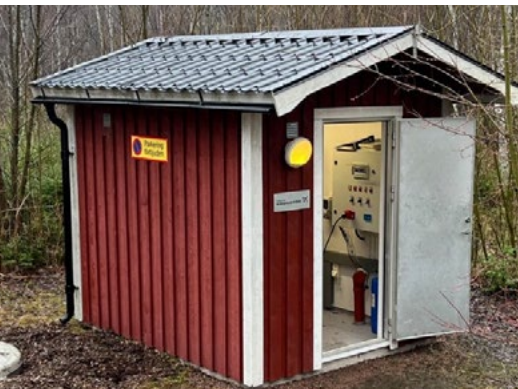
MITTSKÅNE VATTEN Hörö SE Pumping station 100 m 3 /h > 95% odor reduction DEO-100™
